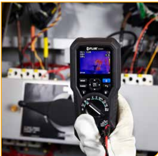
Тепловизионная проверка электрощита
